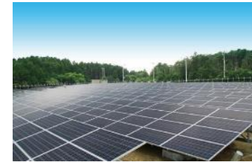
当社施工の太陽光発電システム
