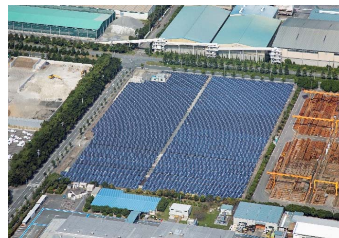
自社保有の太陽光発電設備
