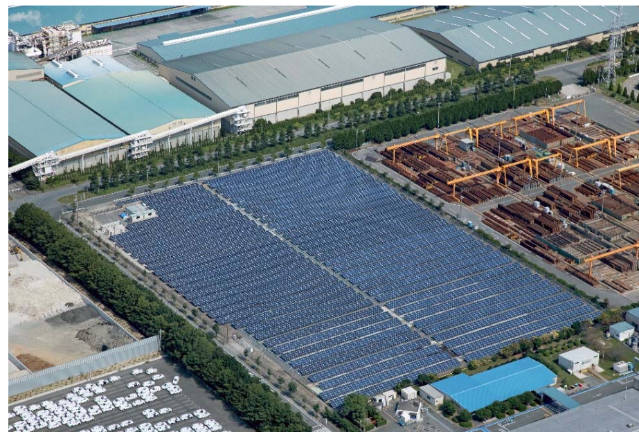
自社太陽光発電設備(愛知県豊橋市 2,394kW)
