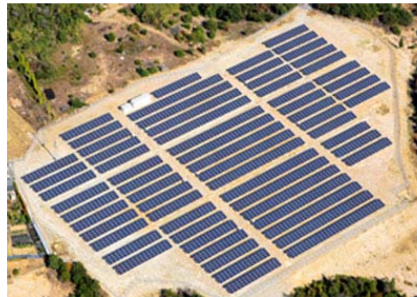
当社施工のメガソーラー（広島県三原市）
